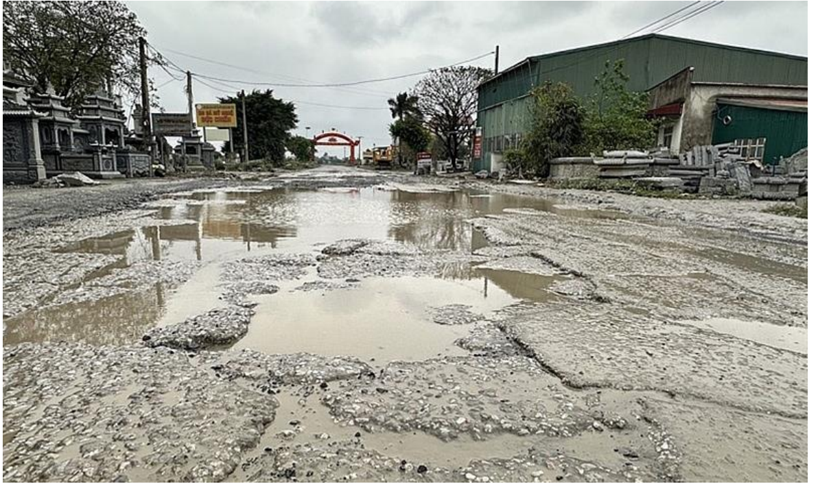
Hình 1.19. Tuyến đường vào làng nghề đá Ninh Vân đã bị hư hỏng, xuống cấp nghiêm trọng. (Ảnh sưu tầm)
